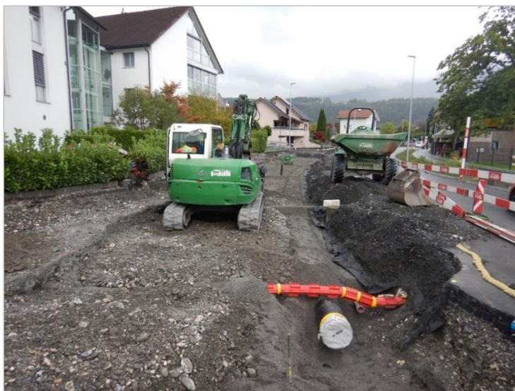
Pumpendruckleitung in der Rheinstrasse
